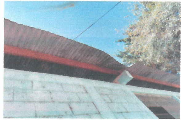
Foto 2: Area donde se desea el mejoramiento del techo en el nivel primario
