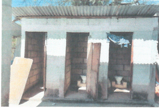
Foto 1: Imagen en donde se desea realizar el mejoramiento de los baños en área de primaria debido a que están en mal estado
